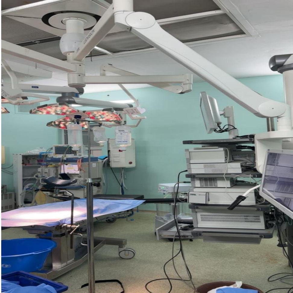
Figure 11 : Salle 3 du bloc opératoire de l'HPZ
